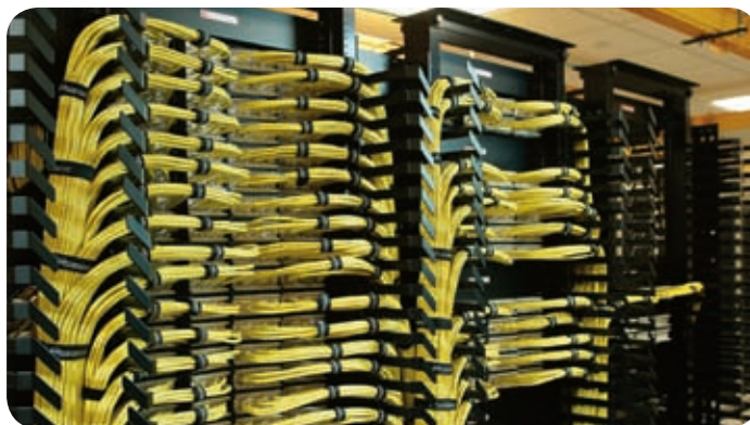
Bastidores de cables
